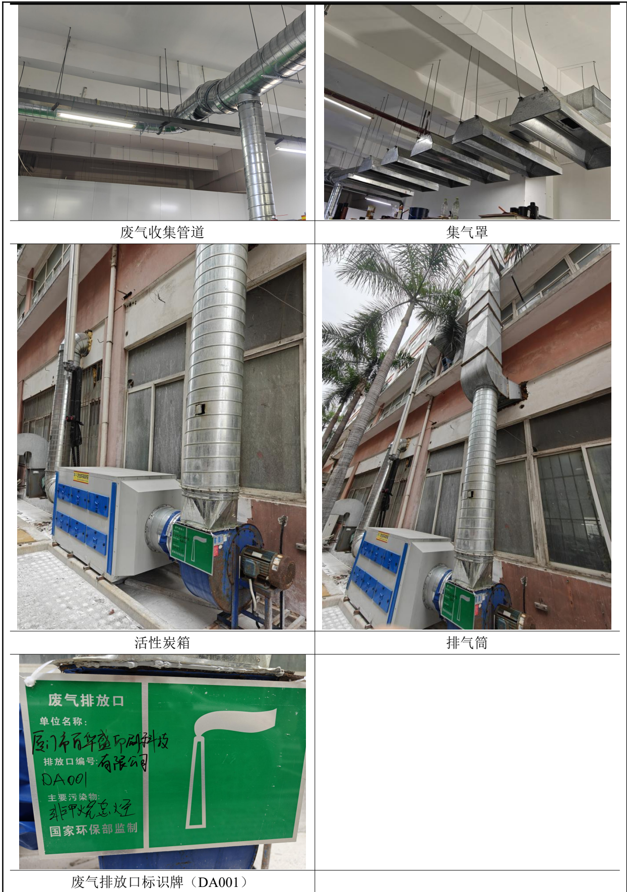
图 3.2 废气治理设施照片
